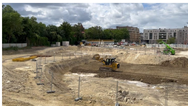
写真13 写真手前からフェンスで囲まれているエリアまでは工事の違法性が認められ、菜園に戻す命令が出されているが、菜園修復が進められている様子は見受けられない。
